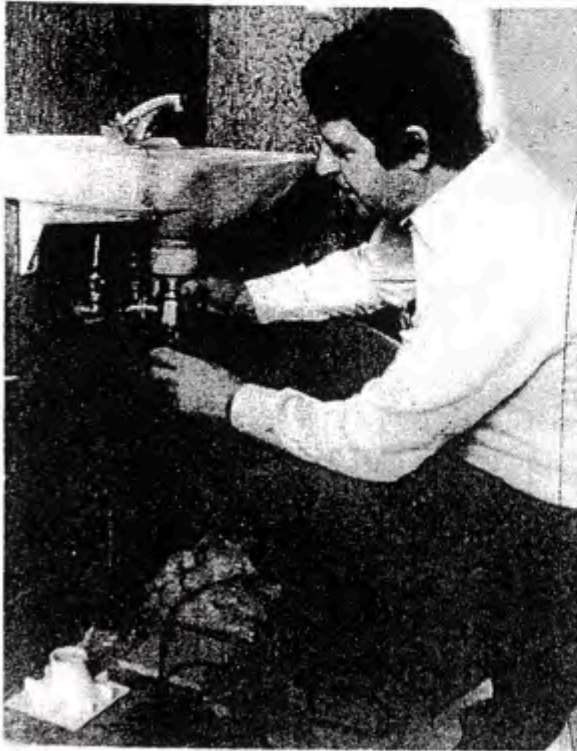
Kun rengøring og småting manglede, da Se & Køb besøgte det nye spejdercenter i fredags. Her er O. B. Sørensen ved at kontrollere en vandlås.
